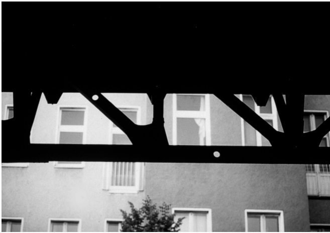
Bild 7. Nicht überlaschte Kernbohrung Ø 65 Fig. 7. Missing structural overcap of the coring
