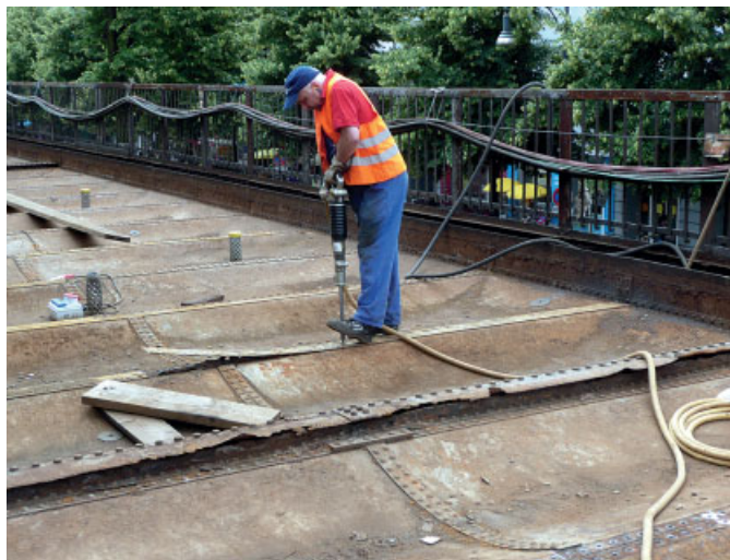
Bild 4. Demontage der Fahrbahnbleche, erkennbar die Korrosionsschäden am Querträger-Auflager (Aufnahme Lorenz & Co. Bauingenieure)
