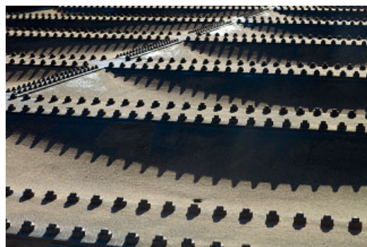
Bild 8. Erneuerte Buckelbleche, HV-Schrauben statt Nieten, vor Aufbringen des Schotterbetts (Aufnahme Lorenz & Co. Bauingenieure) Fig. 8. Replaced buckled plates with high-strength bolts instead of the rivets before inserting the road bed
